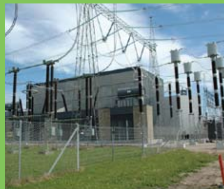
Omformarstation söder om Göteborg.
