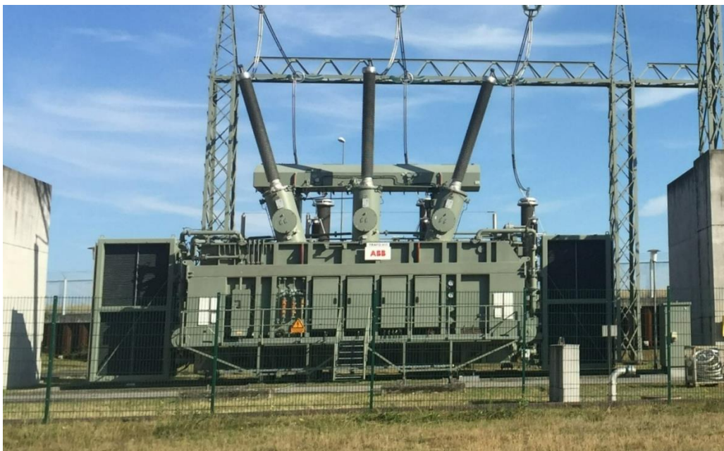
Figur 10: 380 kV trefas krafttransformator utanför Frankfurt i Tyskland. Källa: [21] (Beskuren)
