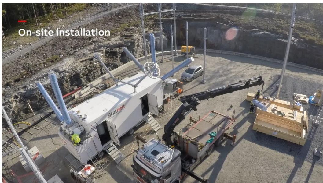
Figur 23: Monteringsfasen av Statnetts mobila GIS-fack. Det är värt att notera att flera stödisolatorer används för anslutningen i detta fall. Källa: [47]
