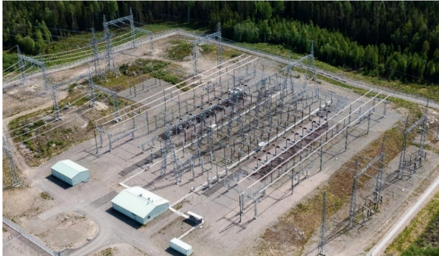
Figur 6: 400 kV tvåbrytarställverk i transmissionsnätet utanför Sundsvall. Den stora byggnaden i nedre vänstra hörnet är kontrollanläggningen (se Stycke 4.2). Källa: [13]
