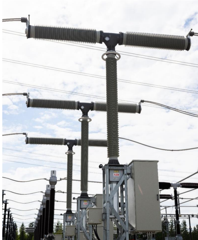
Figur 12: Brytare för 400 kV i en station i transmissionsnätet. Bilden visar en brytare med tre brytarpoler, en för varje fas. Källa: [25]
