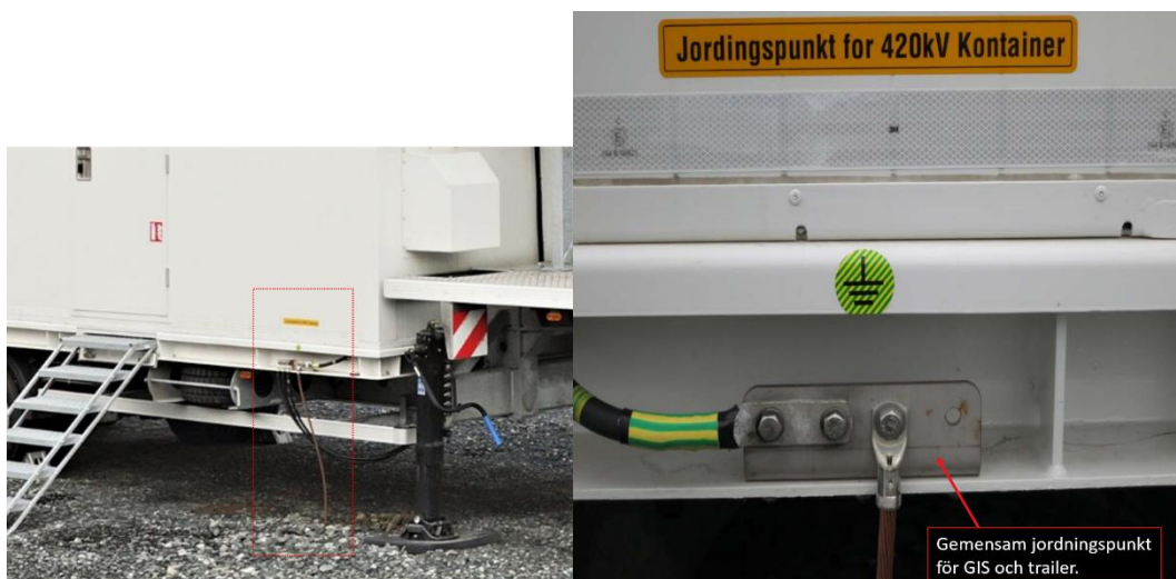
Figur 22: Jordningen av GIS-facket och trailern sker i en gemensam punkt på containerns utsida. Jordledaren går ned till jordlinenätet under mark (se Figur 26). Källa: [31]
