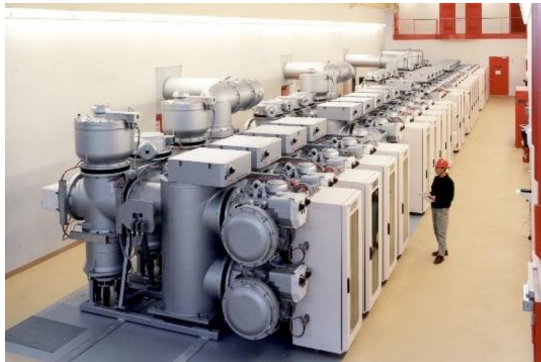
Figur 7: Gasisolerat ställverk för 145 kV i vattenkraftverket Verbois i Schweiz. Källa: [14]
