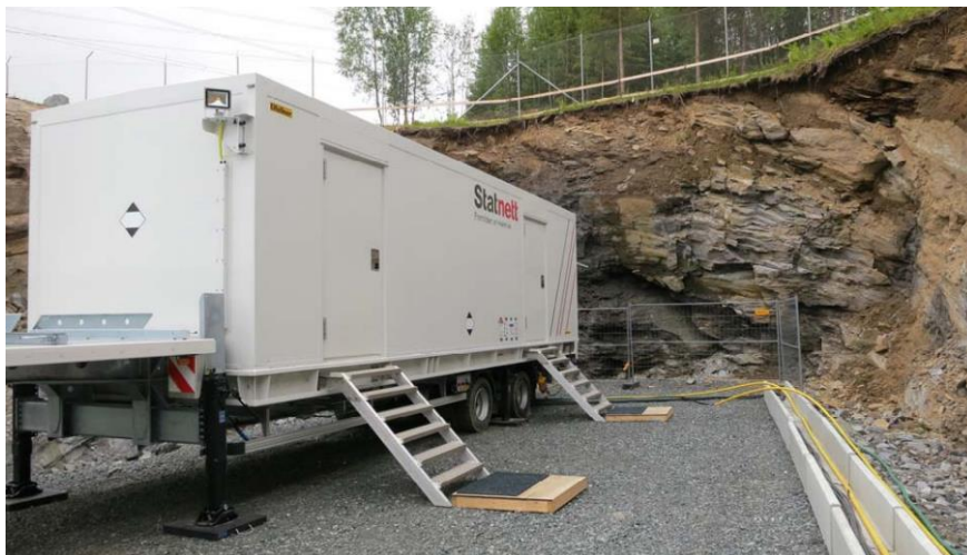
Figur 25: Kontrollanläggningen uppställd och ansluten till GIS-facket. Källa: [31]
