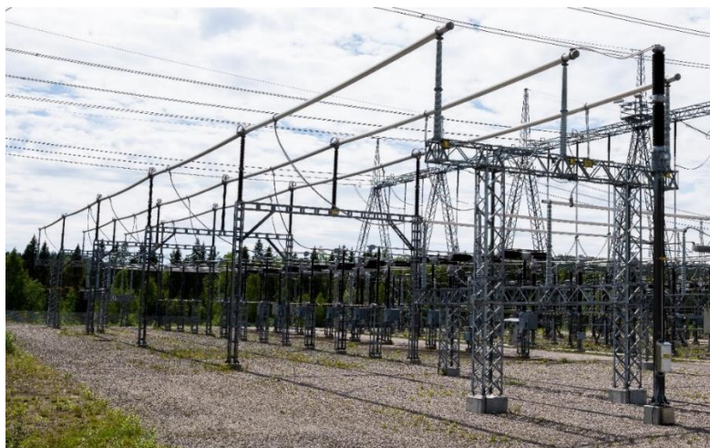
Figur 8: Samlingsskena i ett ställverk utanför Sundsvall. Samlingsskenan utgörs av de tre långa parallella rören som löper diagonalt i bilden. Källa: [13]
