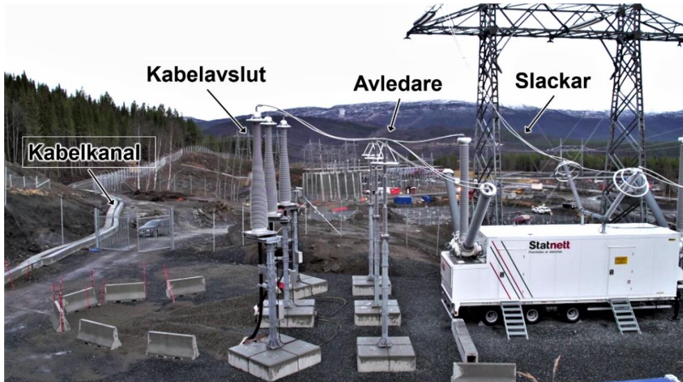
Figur 21: Anslutning av ett mobilt GIS-fack, med slackar på den enda sidan och markförlagd kabel på den andra sidan. Bilden är från transformatorstationen i Bardufoss. Det mobila GIS-facket används här för att ansluta en 420/132 kV krafttransformator till transmissionsnätet. På krafttransformatorns andra sida anslöt regionnätet via ett 132 kV ställverk. Källa: [47]
