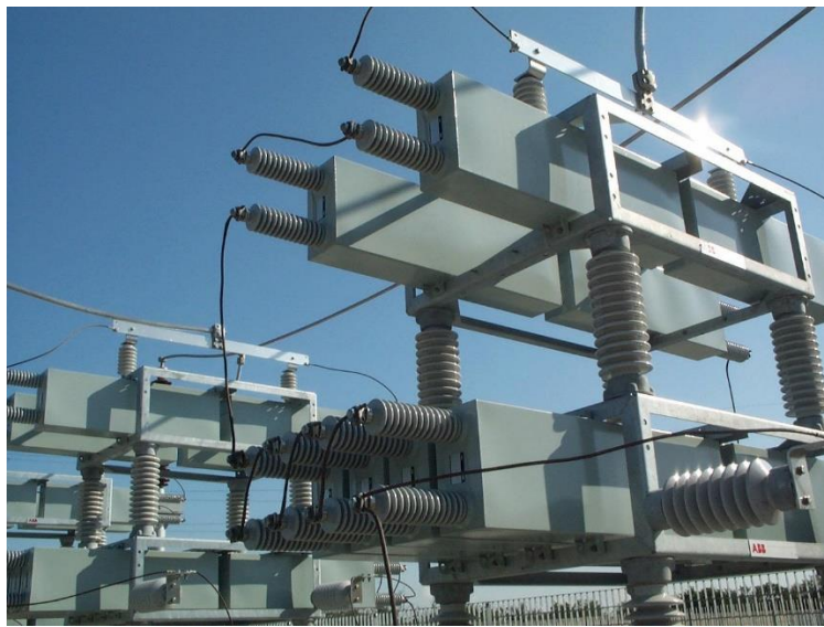
Figur 11: Shuntkondensatorbank i anslutning till en transformatorstation. Källa: [22]
