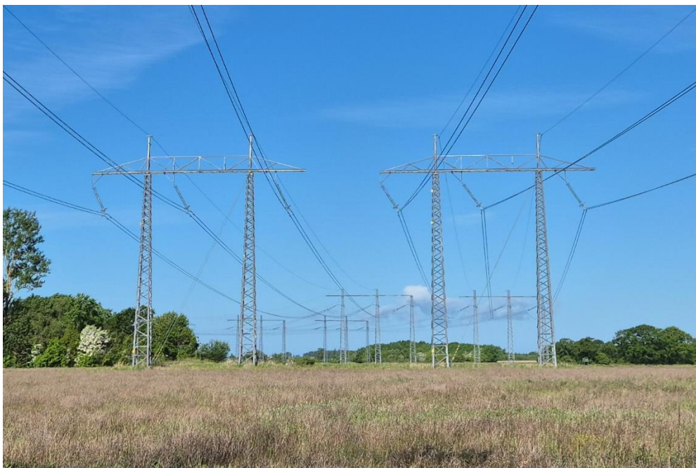
Figur 4. Befintliga portalstolpar och vinkelstolpar av aktuella ledningar vid Klappevägen, vy mot väst. Till vänster ledning FL23 och till höger ledning FL25.
