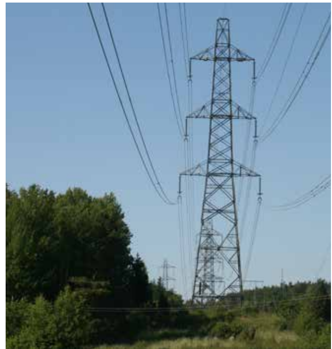
Figur 12. Exempelbild av en julgransstolpe i stål.
