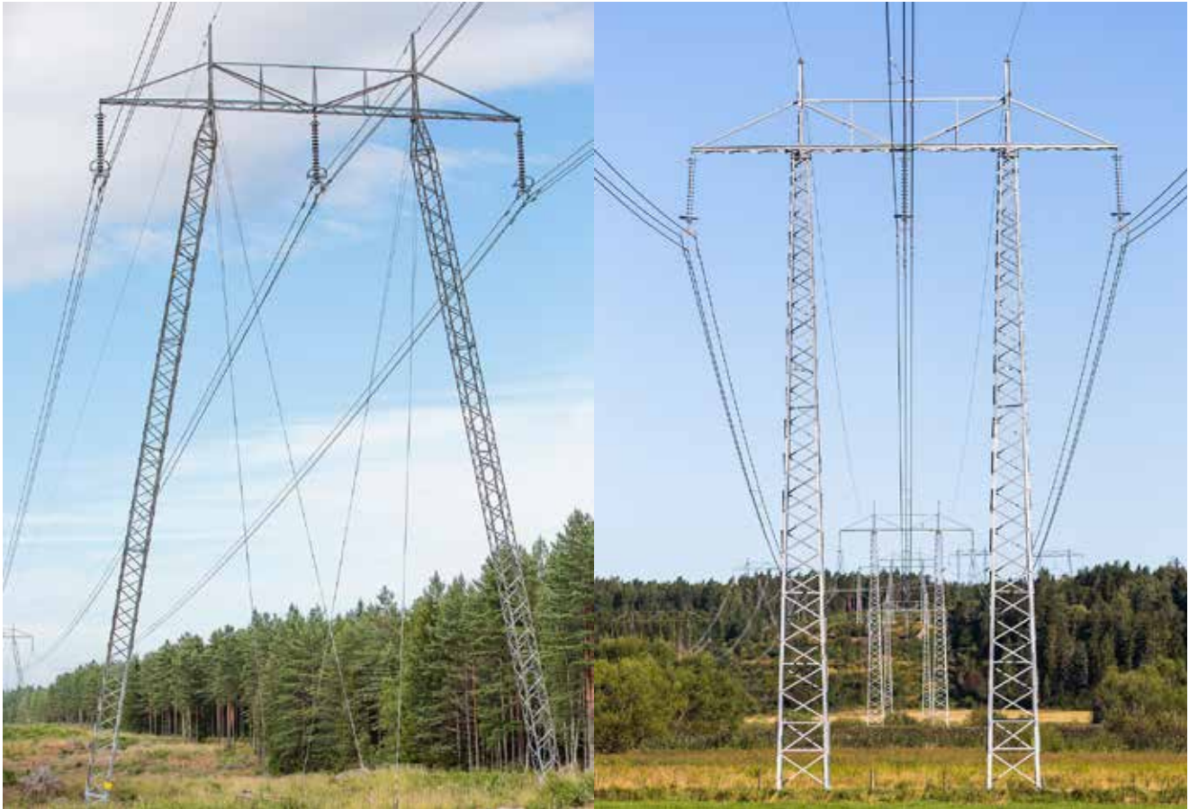
Figur 10. Exempel på portalstolpar. A-stolpe, avstånd mellan ytterfaser cirka 18 m. B-stolpe, avstånd mellan ytterfaser cirka 22 m.
