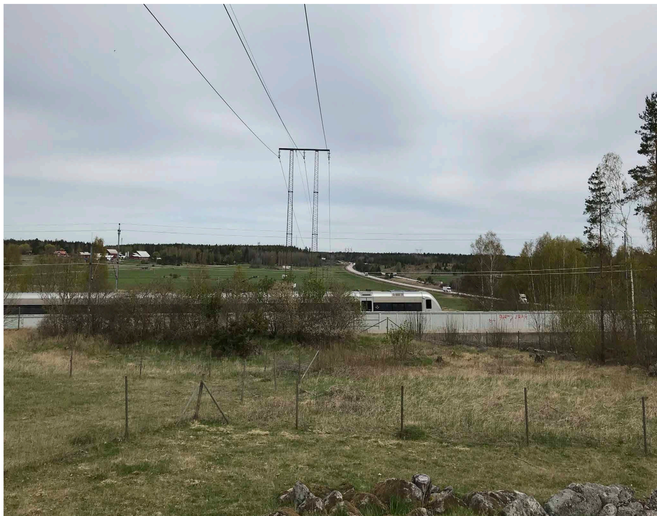
Figur 18. Vattenfalls befintliga ledning vid passage över Arlandabanan. Väg E4 syns till höger i bild. Foto taget i nordlig riktning.
