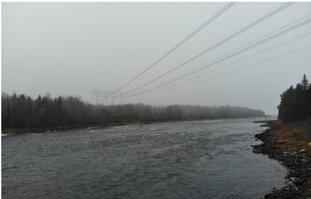
Figur 56. Passage vid Torneälven. Fotomontage över befintlig transmissionsnätledning (högra ledningen) och planerad ledning (vänstra ledningen) över Torne älv. Fotot är taget från den finska sidan av älven. Foto: Fingrid Oyj 2019.
