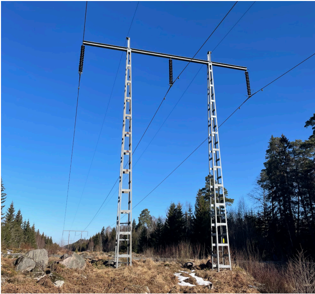
Figur 18. Utformning och foto på befintlig 220 kV portalstolpe av KL21 S1.
