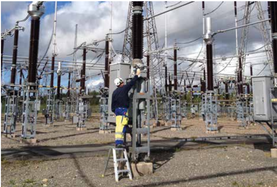
Arbete på en brytardel i praktiken. De elektriska fälten kan minskas beroende på var arbetet utförs.
