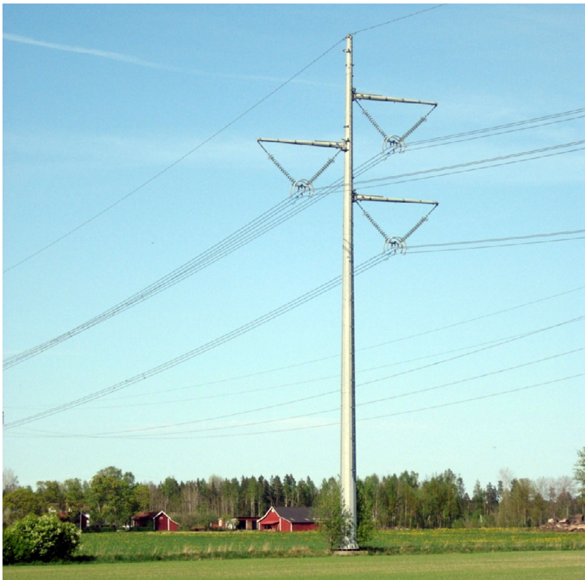
Bild 9. Kompaktstolpe för 400 kV med fasledarna i triangelform.
