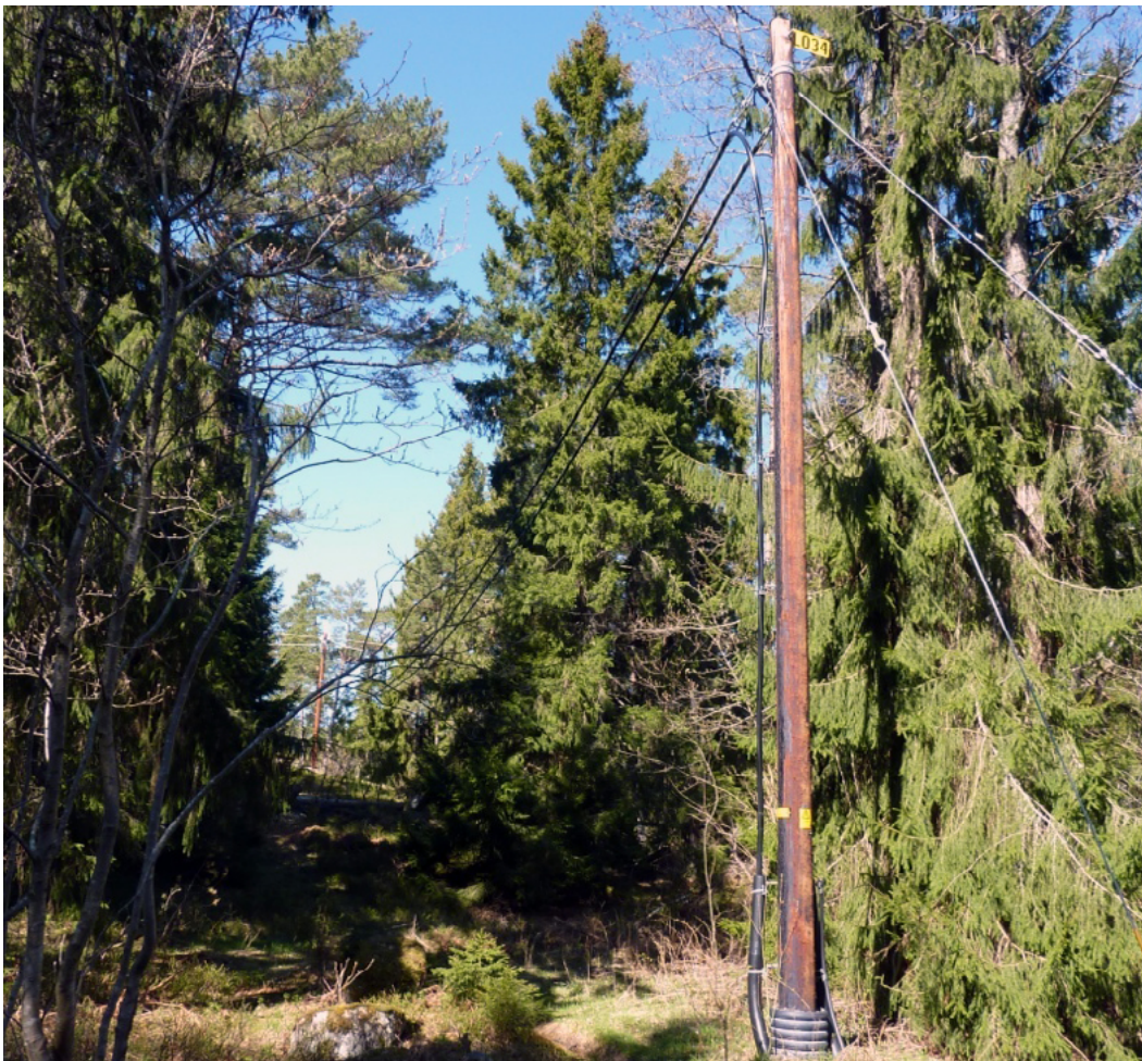
Luftledning med hängkabel, 10 kV.
