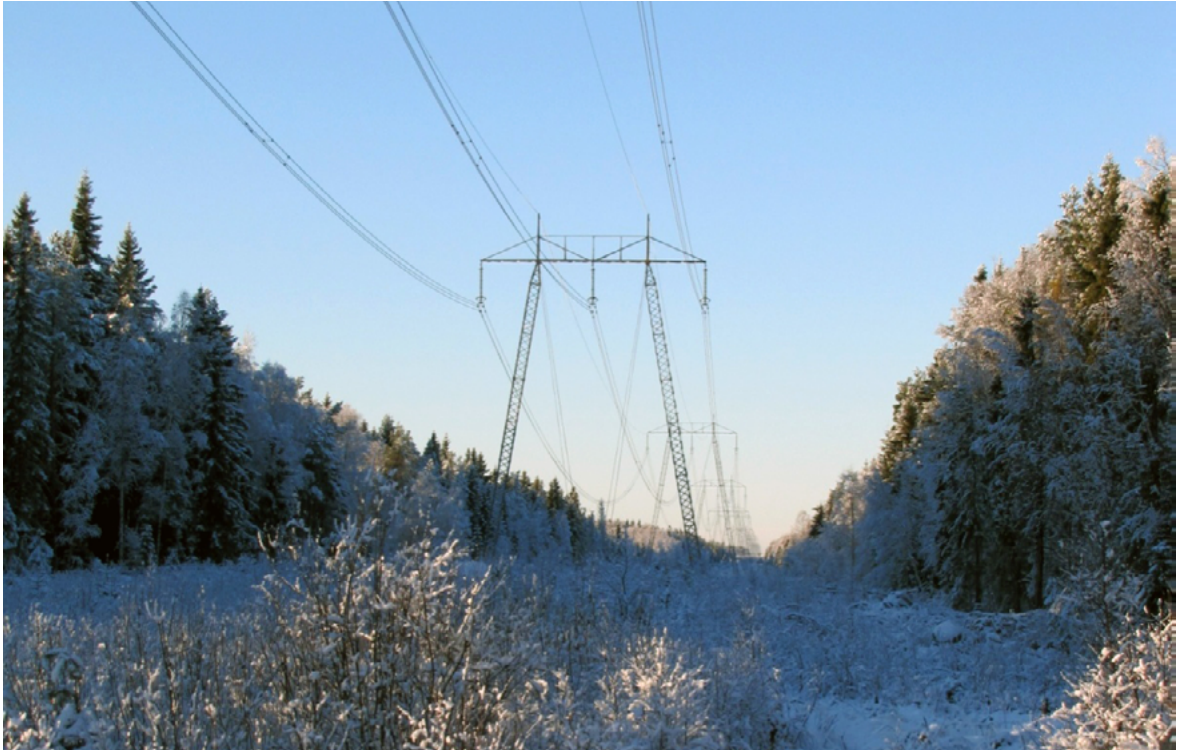
Luftledning för 400 kV.
