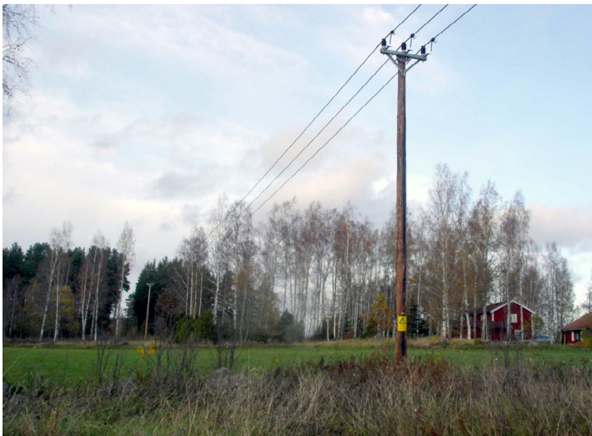
Luftledning med isolerade (plastbelagda ledare, BLL), 10 kV.
