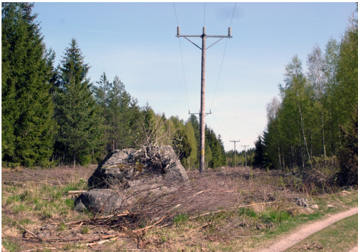
Luftledning med oisolerade ledare, 40 kV.
